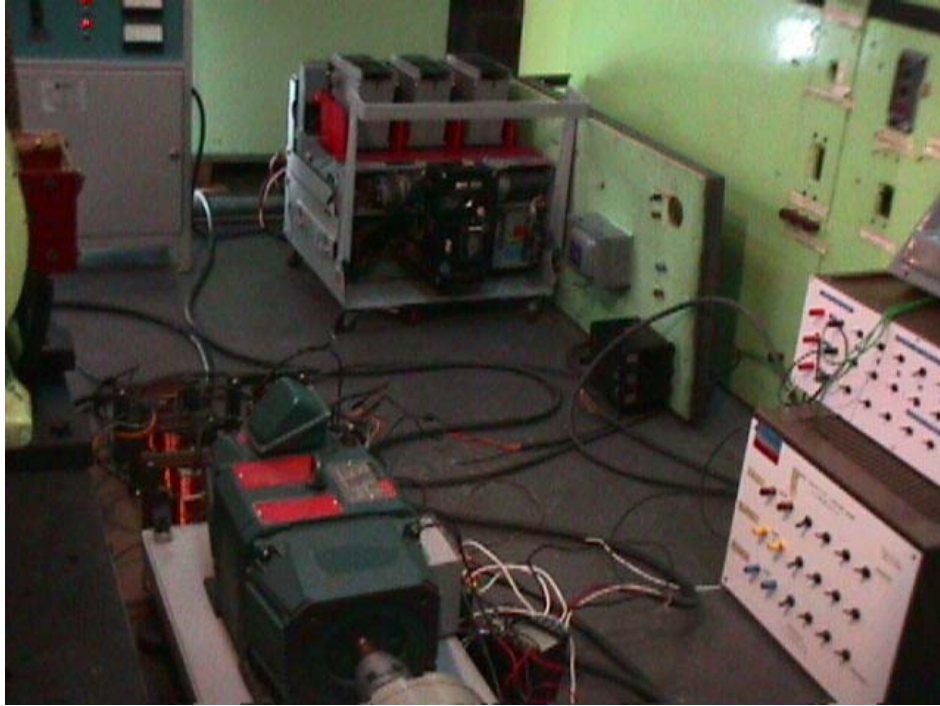
Figura 3.12. Interruptor, banco de carga inductiva y motor generador como carga.
